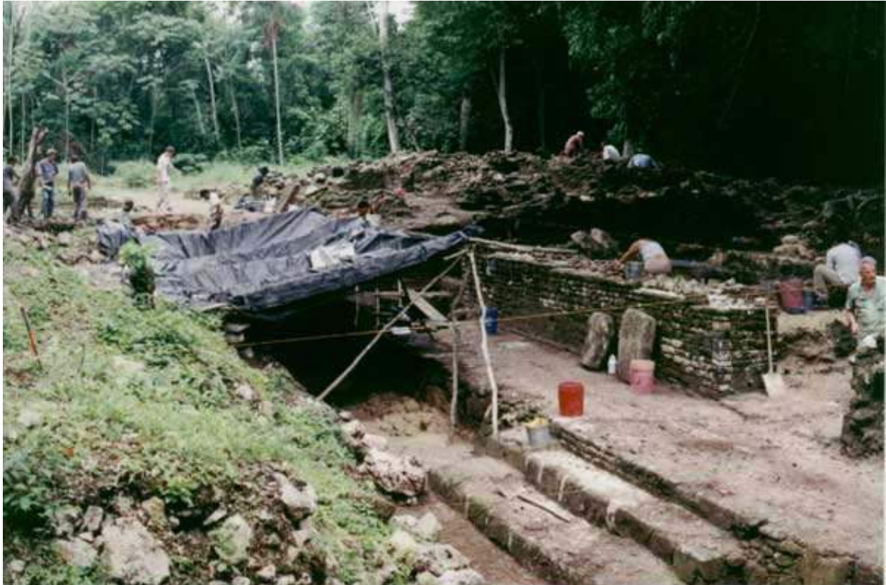
Figura 2:15. Vista de la Operación 4, con la excavación del nivel de la demolición (debajo de la cubierta) y en pleno trabajo de la escuela de campo dentro de N10-28 y N10-15. Los trabajadores en el fondo están retirando núcleo del frente de N10-15.
