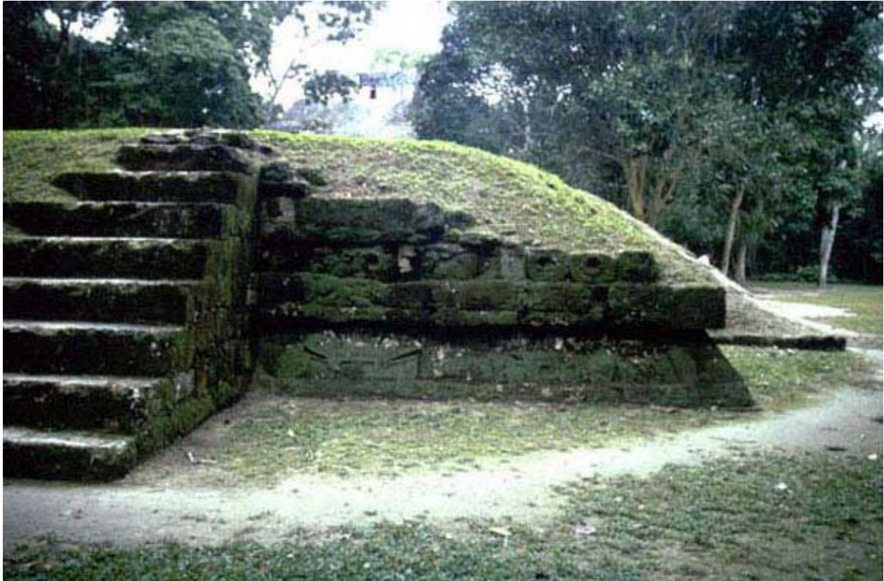
Foto 41. Tikal, Estructura 5C-53, parte fachada sur, muy húmeda, 12 de diciembre, 2000.
