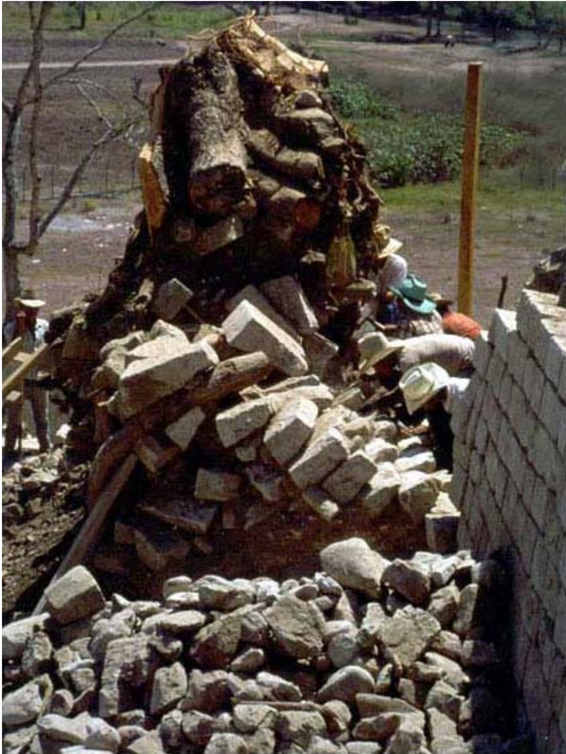
Foto 51. Copán, Estructura 10L-21, parte norte, proceso de restauración por anastilosis, marzo de 1991.
