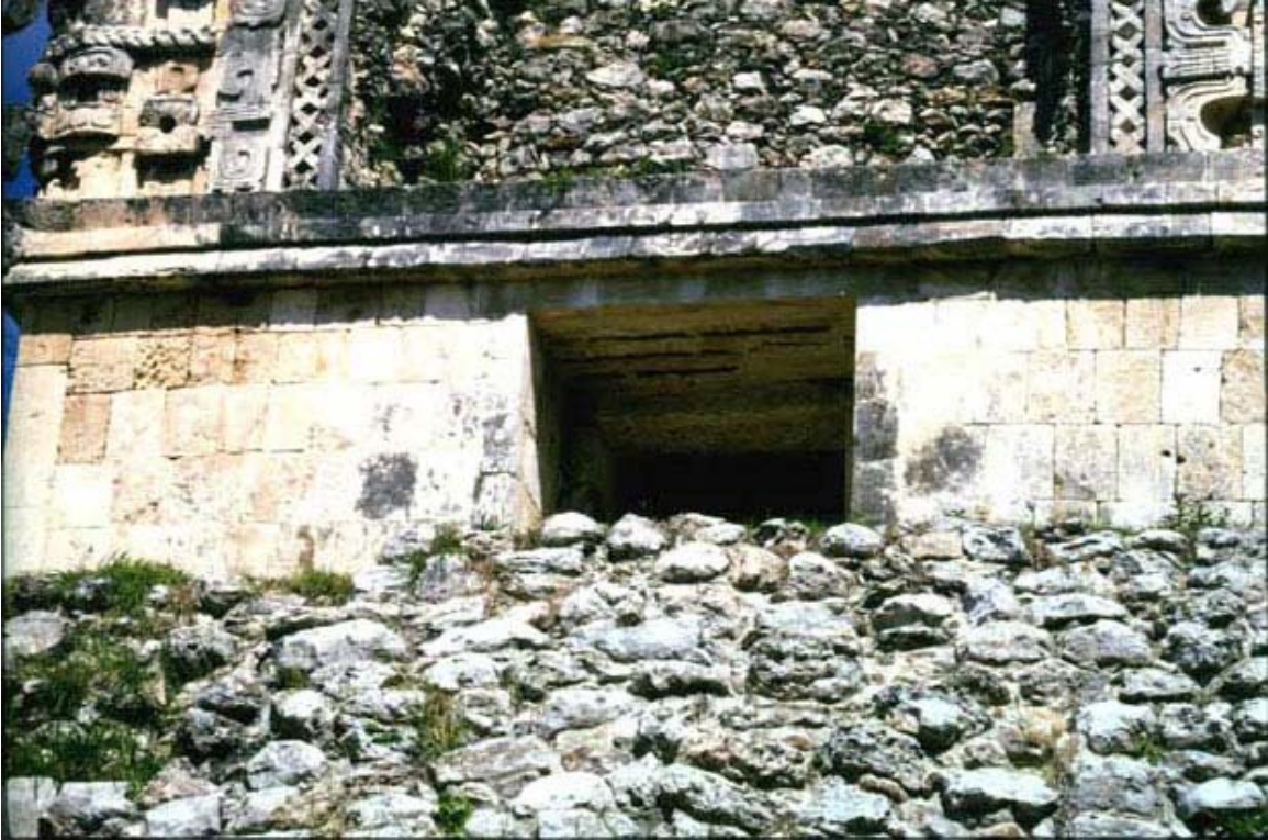
Foto 13. Uxmal, Cuadrángulo de las Monjas. Dintel de concreto deteriorado, 28 de julio, 2000.
