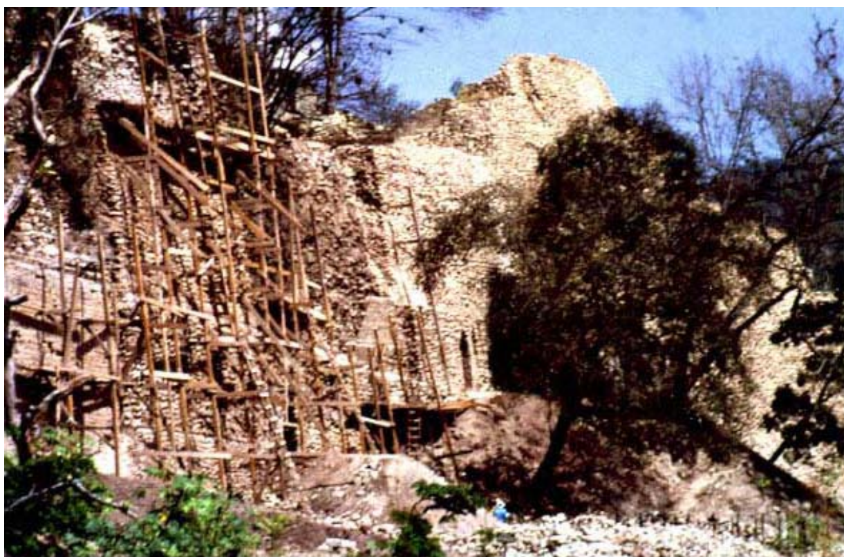
Foto 64. Copán, corte arqueológico, en pleno trabajo de estabilización. Durante todo el trabajo se utilizaron andamios de madera, 1992.
