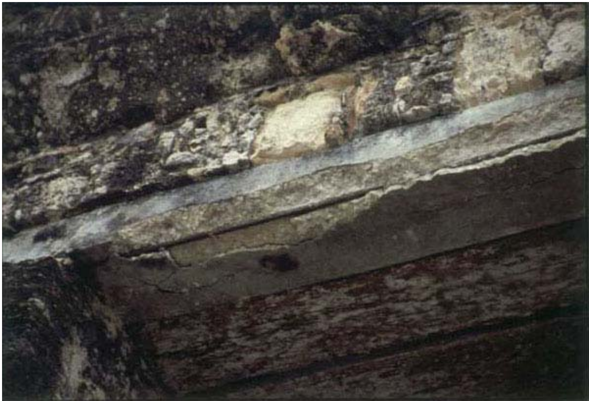
Foto 14. Tikal, Templo IV, dintel de concreto deteriorado, 22 de mayo, 1991.
