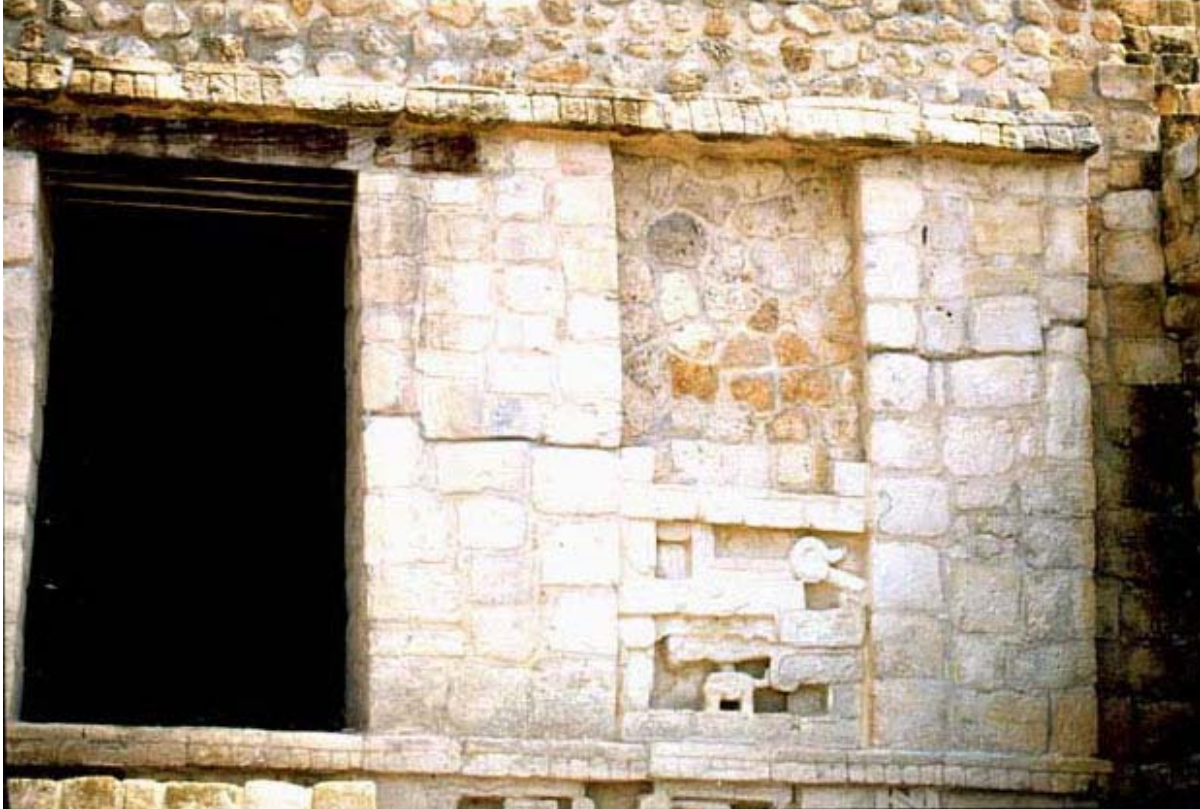
Foto 29. Ek Balam, Templo 1, detalle de juntas parcialmente vacías para dividir lo integrado de lo original, 1 de agosto, 2000.
