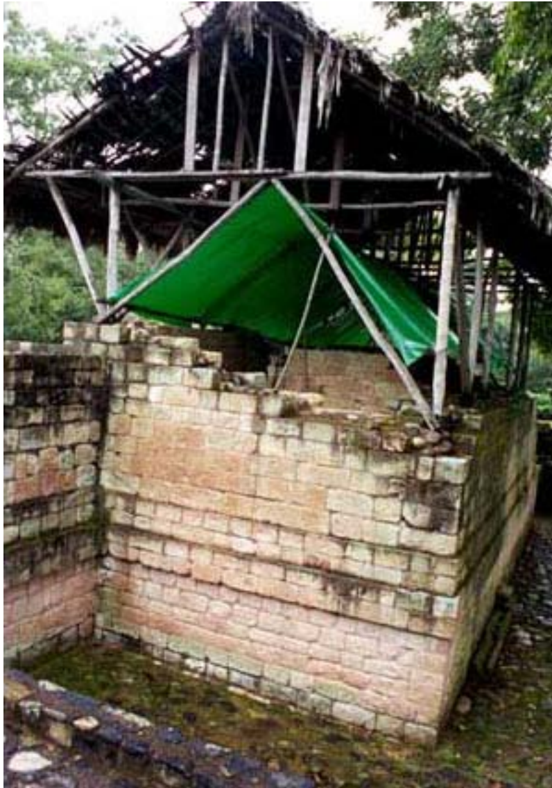
Foto 55. Copán, Estructura 9N-67, el techo protector se encuentra en un estado calamitoso, 22 de noviembre, 2000.
