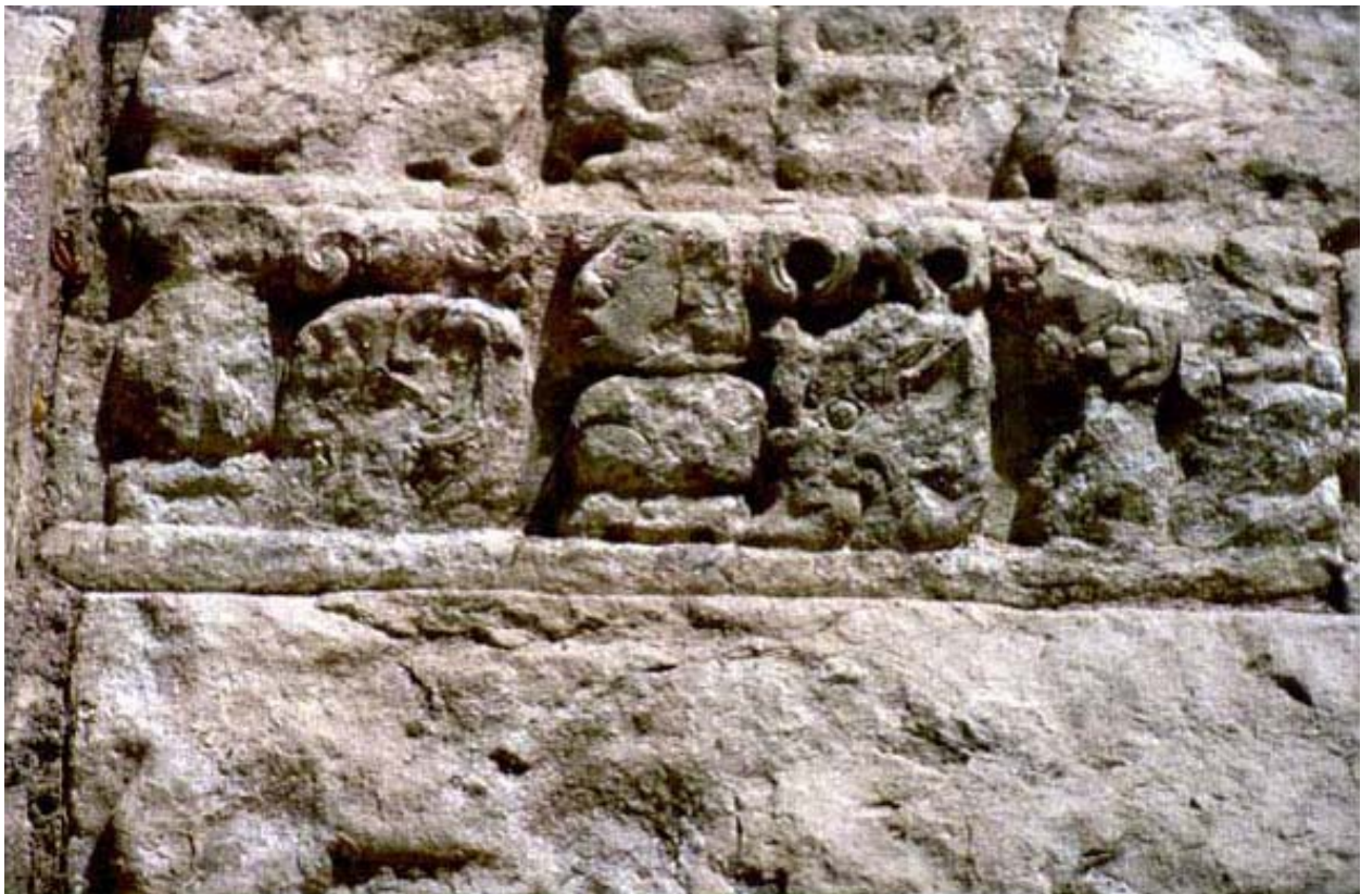
Foto 67. Copán, la Escalera Jeroglífica, detalle del deterioro de los escalones en la base de la escalinata.
